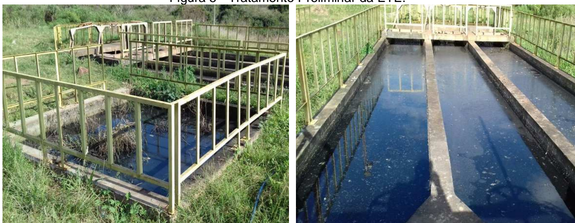
Figura 5 - Tratamento Preliminar da ETE.
