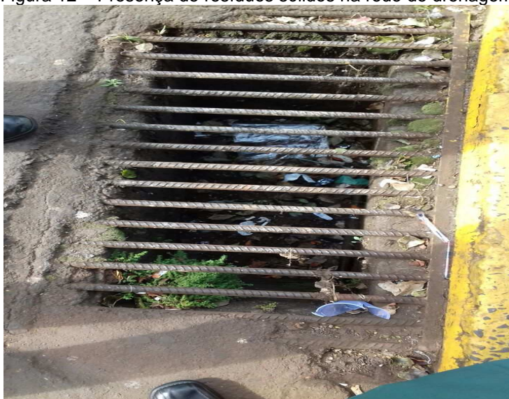
Figura 12 – Presença de resíduos sólidos na rede de drenagem.
