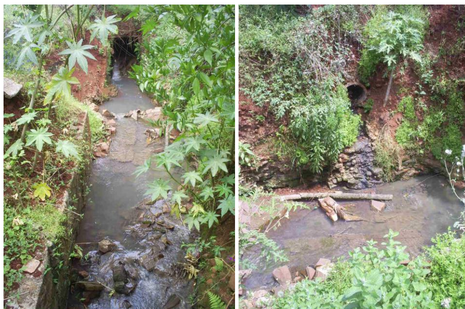
Figura 4.2 – Problemas de desmoronamento das paredes do arroio Curtume e ponto de lançamento de esgoto irregular no mesmo local.
