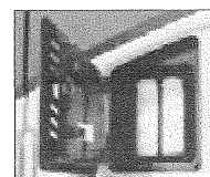
Filtro externo do ar condicionado
