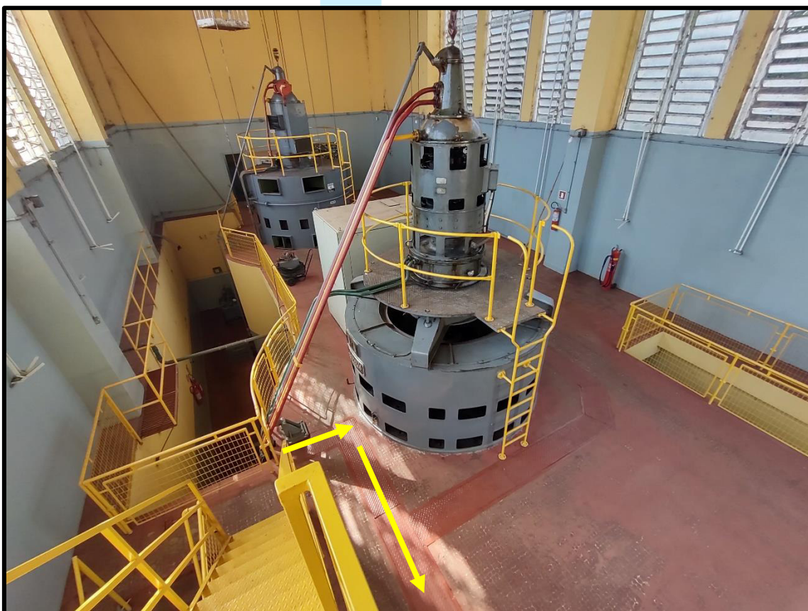
Figura 31 - Pontos de passagem da fiação elétrica.
