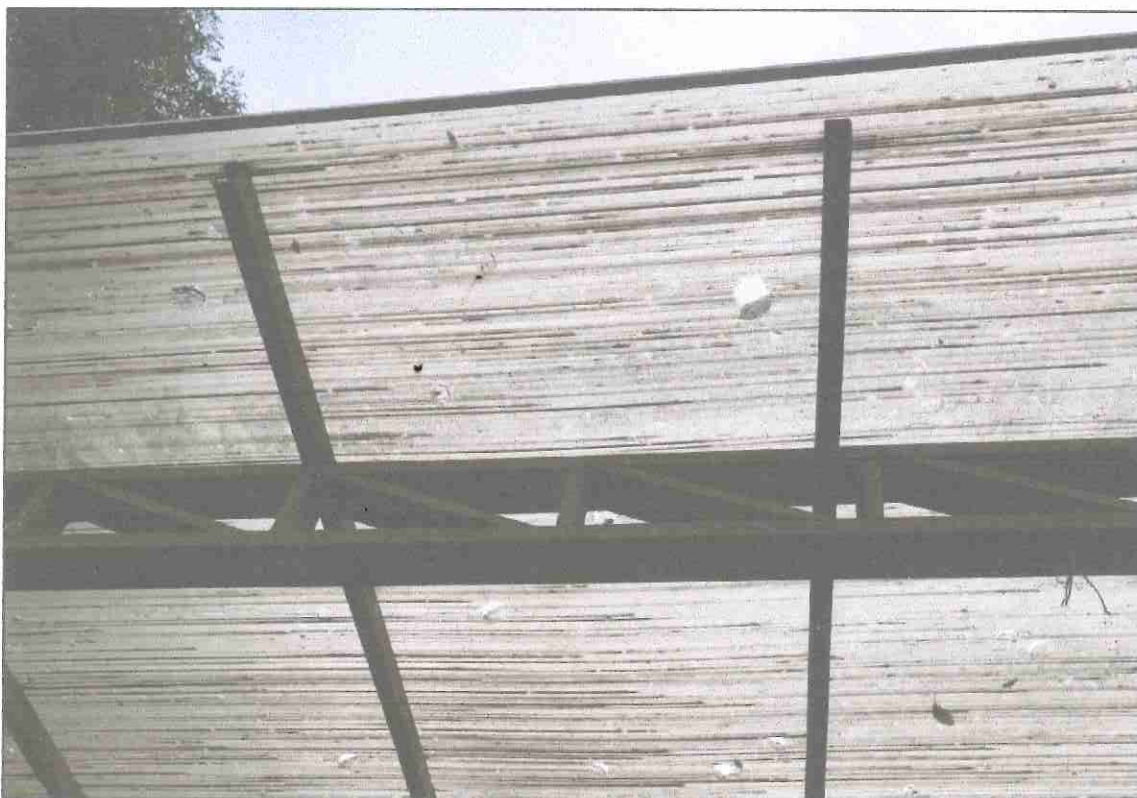
Telhas de policarbonato furadas após serem atingidas pela tempestade de granizo.
