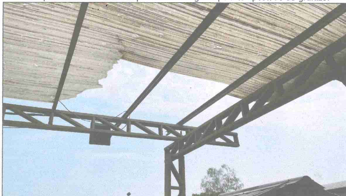
Telhas de policarbonato furadas e quebradas após serem atingidas pela tempestade de granizo.
